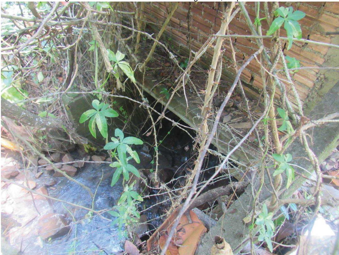
Figura 67: Início do segundo trecho tubulado do curso d'água "E", no ponto R4
