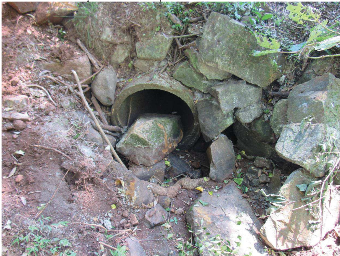
Figura 141: Saída da tubulação do curso "L" no ponto R31.
