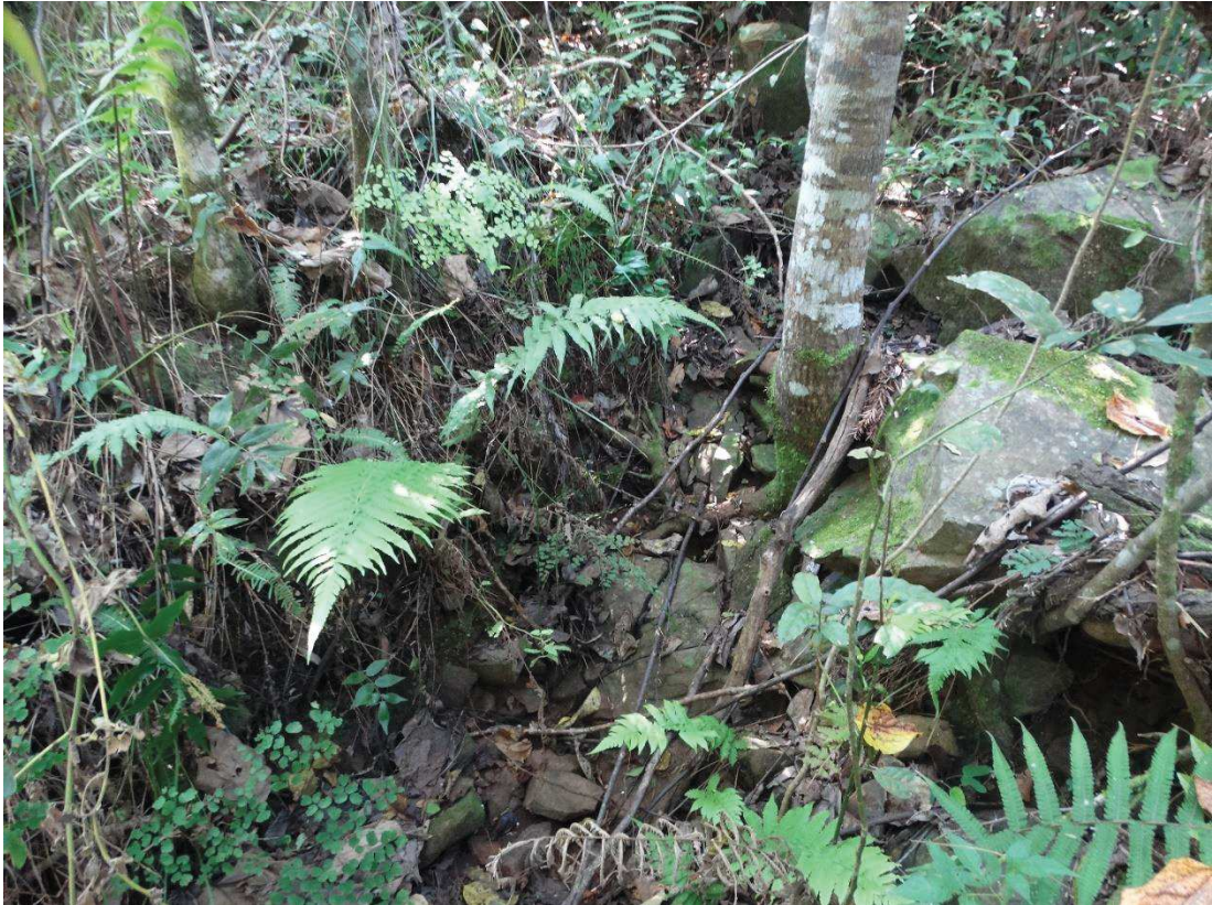
Figura 75: Trecho drenagem descaracterizado, localizado no ponto R93
