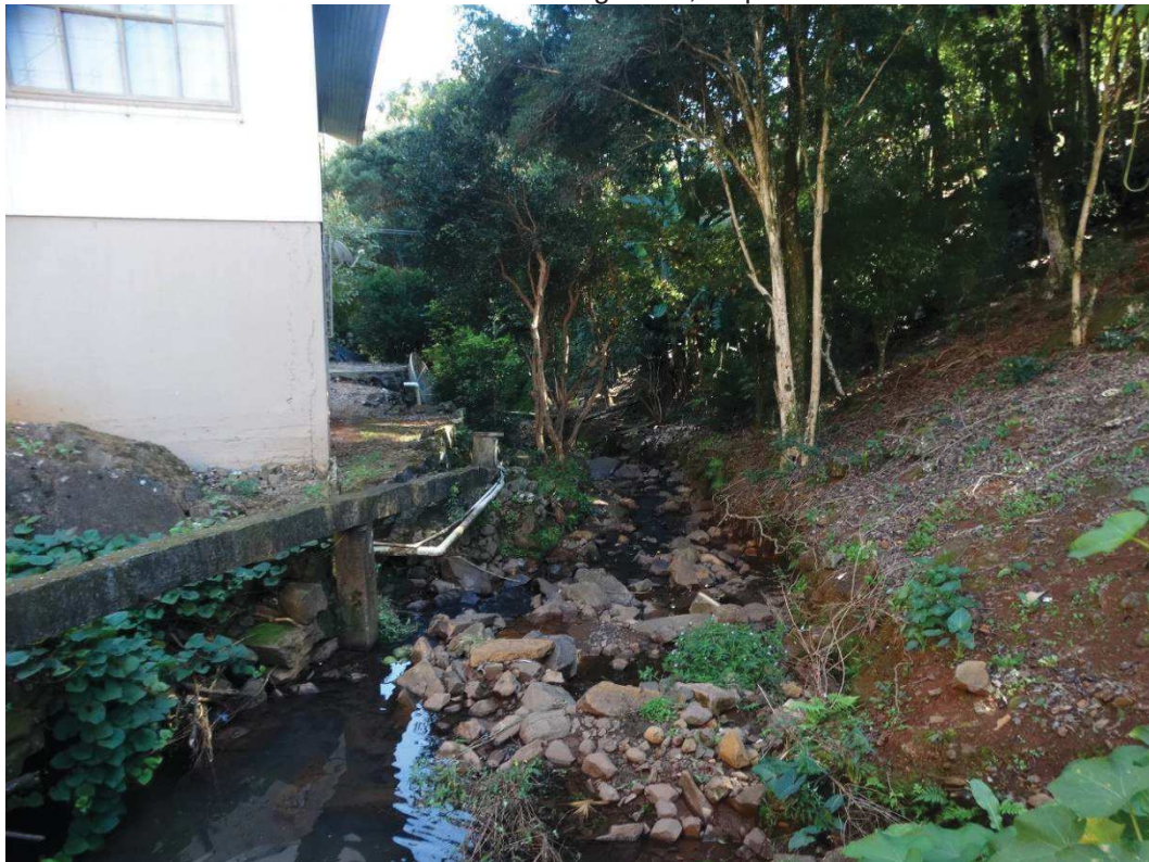
Figura 90: Início do trecho a céu aberto do curso d'água "F", no ponto R14
