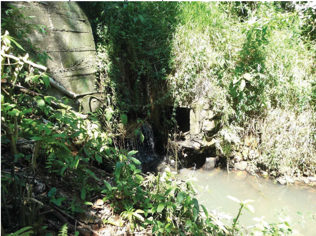
Figura 74: Fim da tubulação do curso d'água "E" no ponto R75
